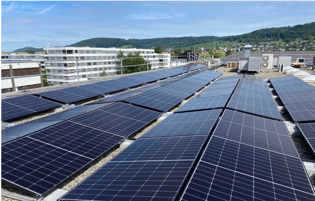
Die grösste städtische Photovoltaikanlage (PVA) an der Rütistrasse in Schlieren geht in Betrieb Bild: zvg
